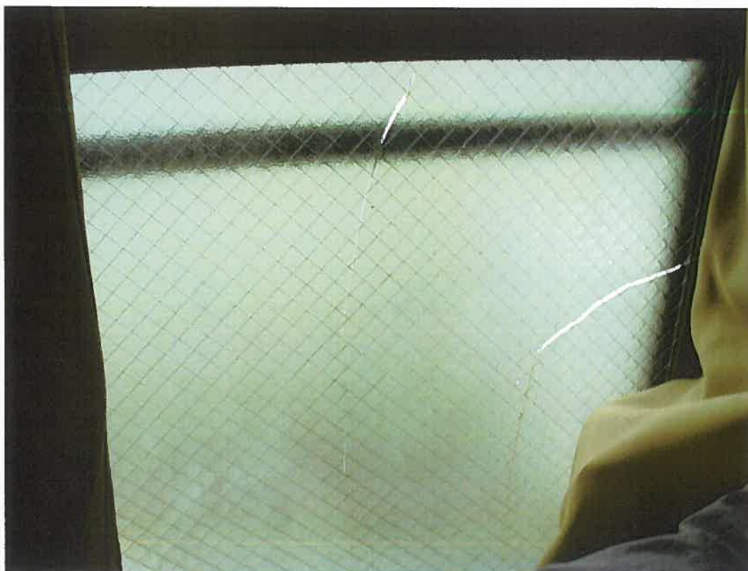
東側の窓ガラスの亀裂：2 か所目 (向かって右)
