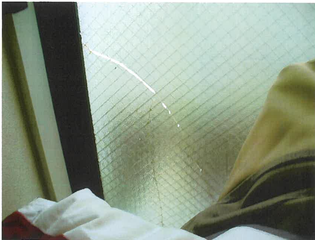
東側の窓ガラスの亀裂：1 か所目 (向かって左)
