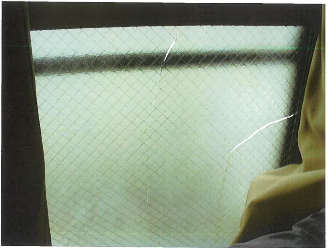
東側の窓ガラスの亀裂：2 か所目 (向かって右)
