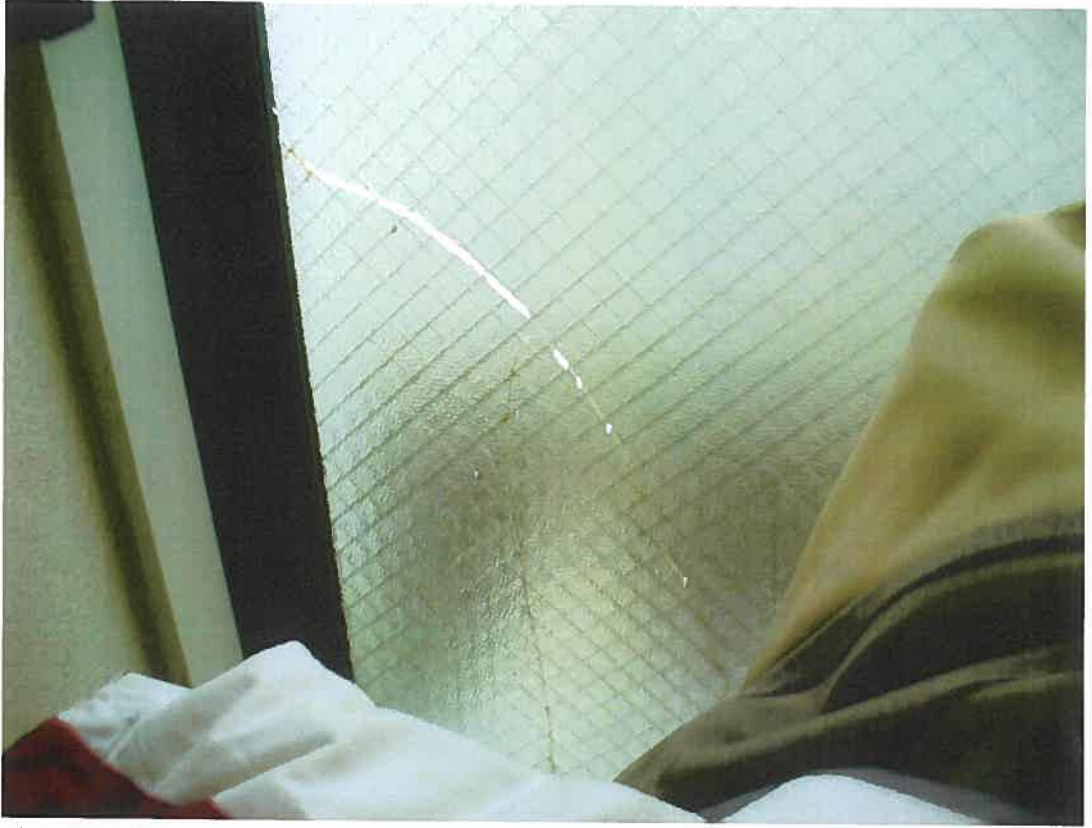
東側の窓ガラスの亀裂：1 か所目 (向かって左)
