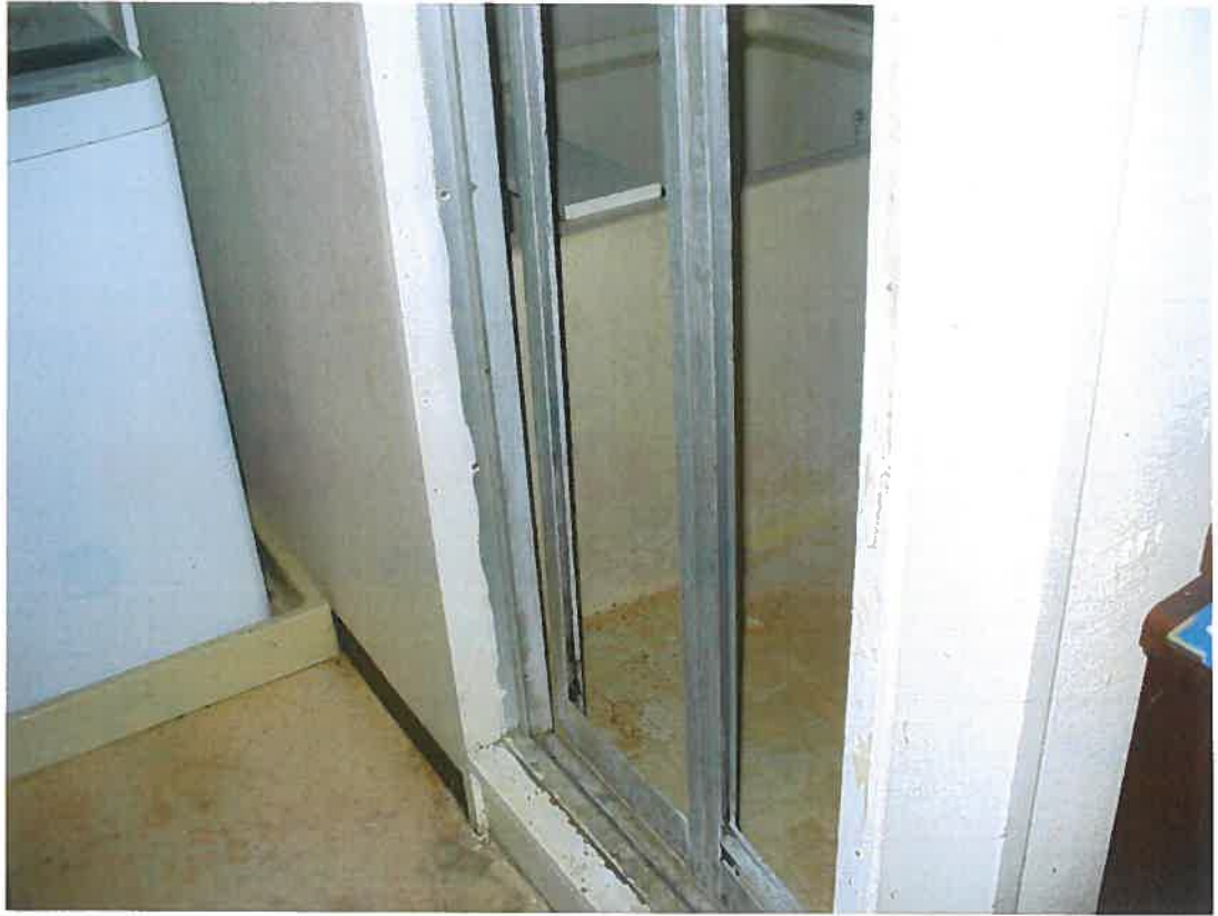
浴室の扉の一部の欠損
