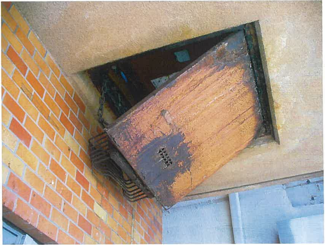
バルコニーの天井部分の避難ハッチの破損
