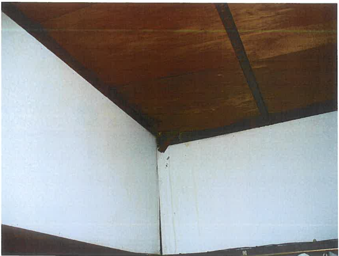
1 階和室(店舗)南西角の天井部分の雨漏りによる損傷
