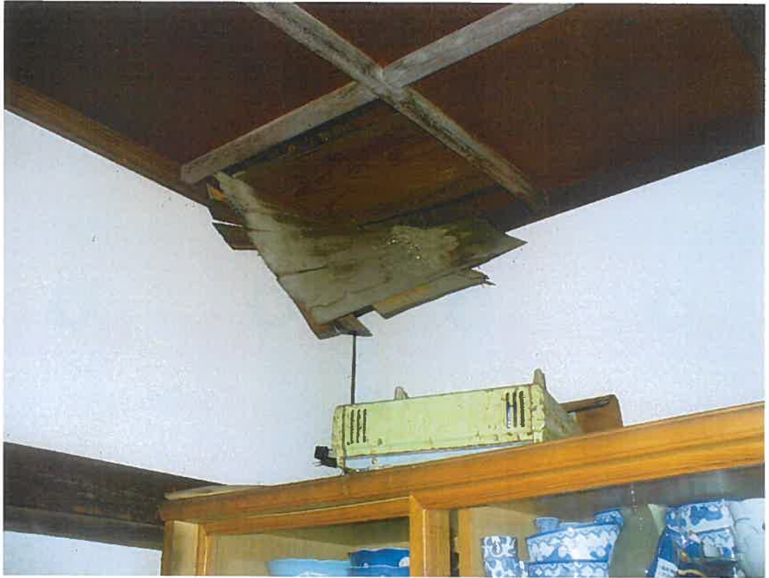
1 階台所の北西角の天井部分の雨漏りによる損傷
