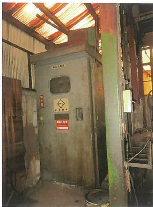
※キュービクルの外観
