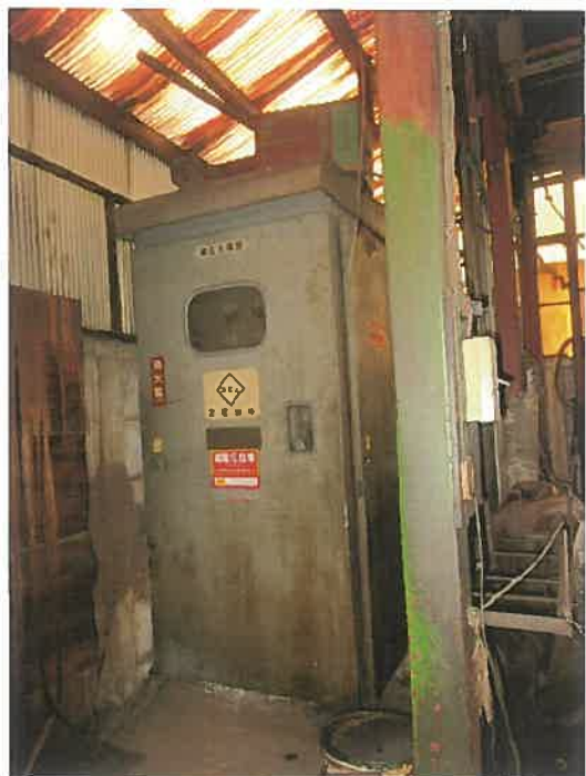
※キュービクルの外観
