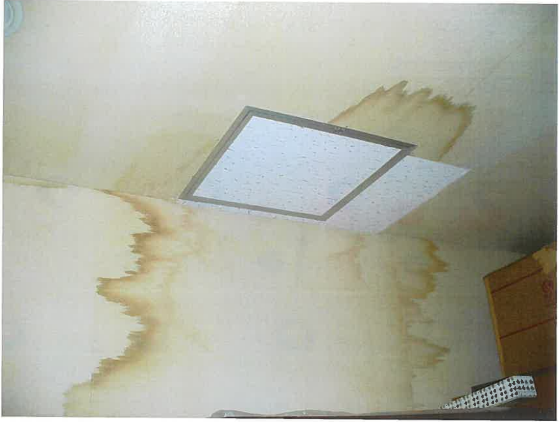
2 階東端洋室の北側壁とその上部の天井の雨漏りの跡
