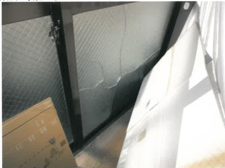
⑥ 建物内の状況 窓ガラスのひび割れ
