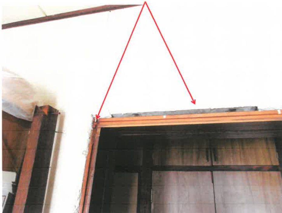
壁面の損傷状況
