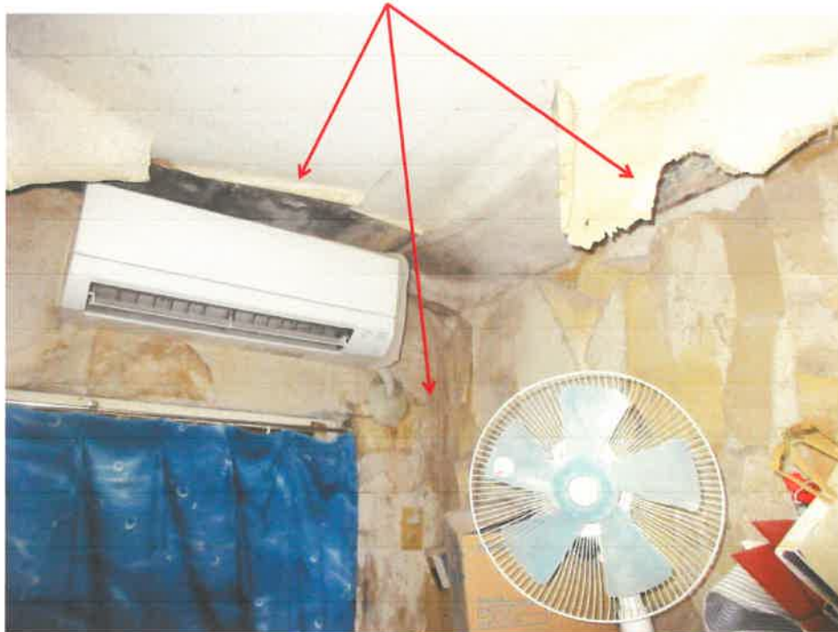
天井・壁面の損傷状況
