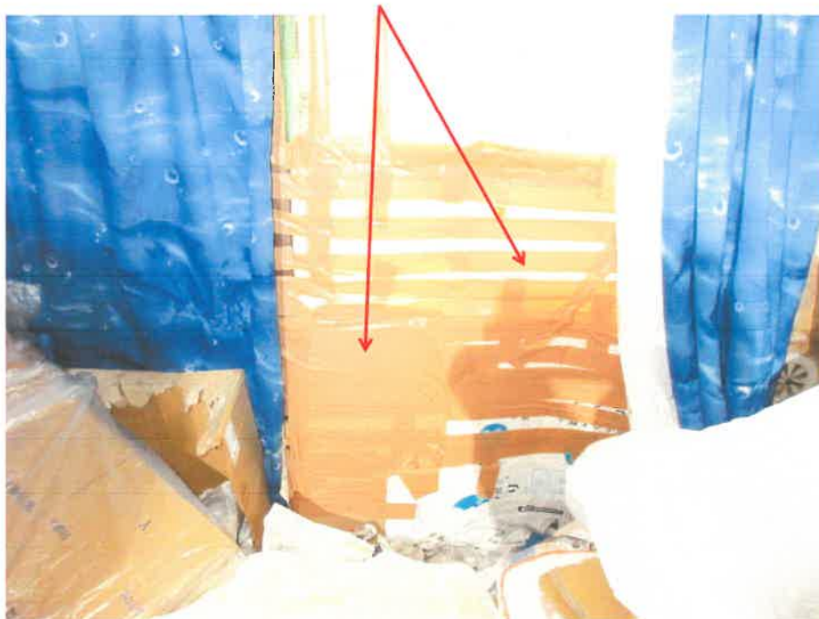
窓の損傷状況
