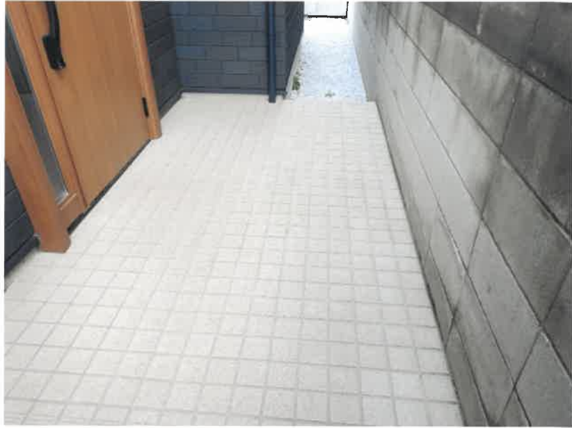
⑦玄関ポーチ部分の足元のタイルが隣家の壁に接触している状況
