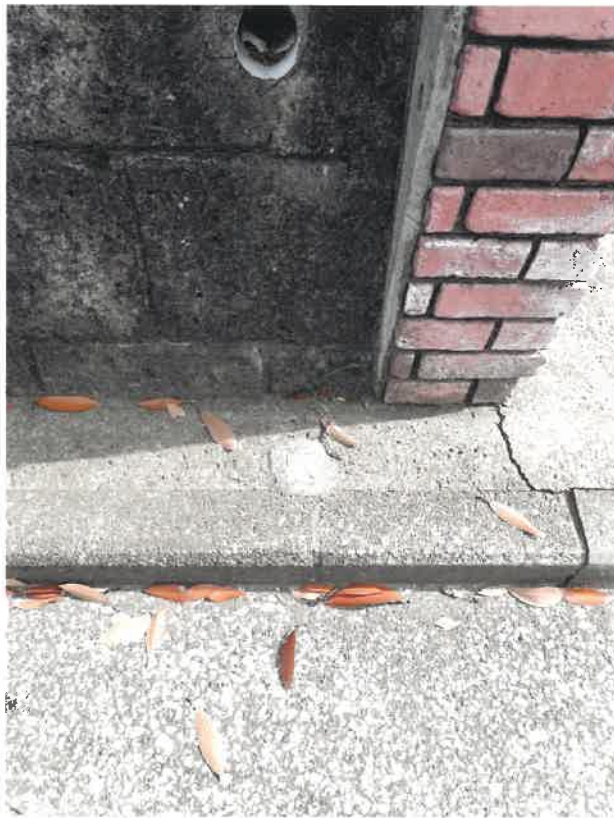
⑧物件1土地の北東部分、境界標を超えて公園壁面が写真右方向へ越境している状況
