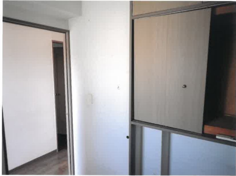
⑦壁面損傷の状況（写真中央、電気スイッチの右斜め上）
