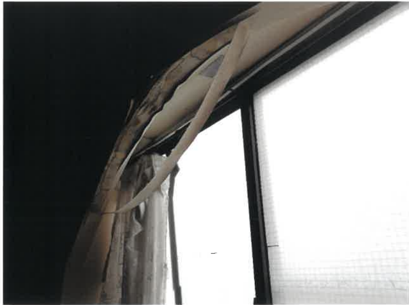
⑤ 1階出窓雨漏りによる損傷の状況
