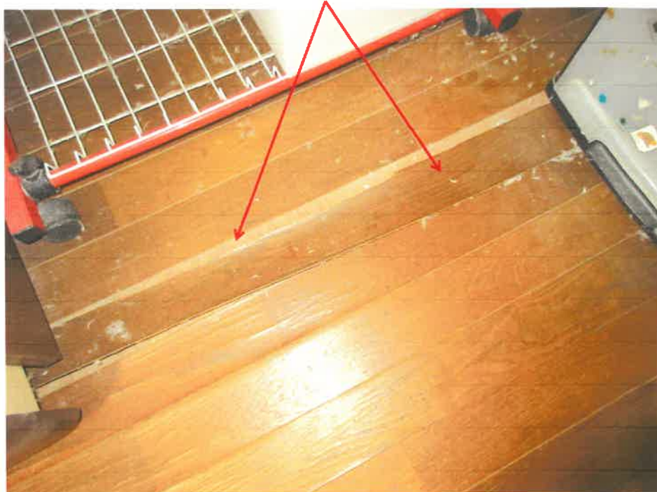
床の損傷状況
