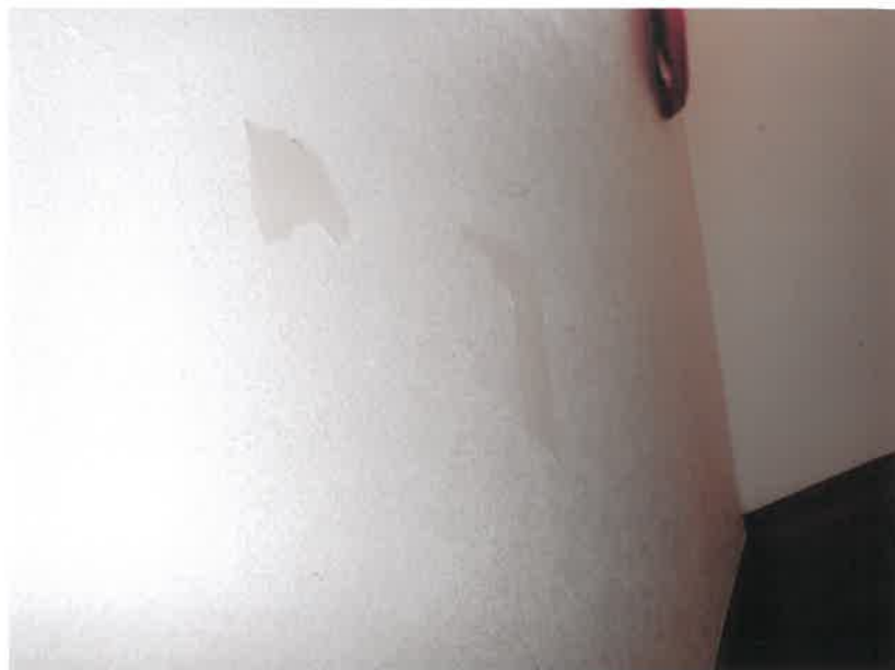
⑦階段壁面の壁紙剥離の状況
