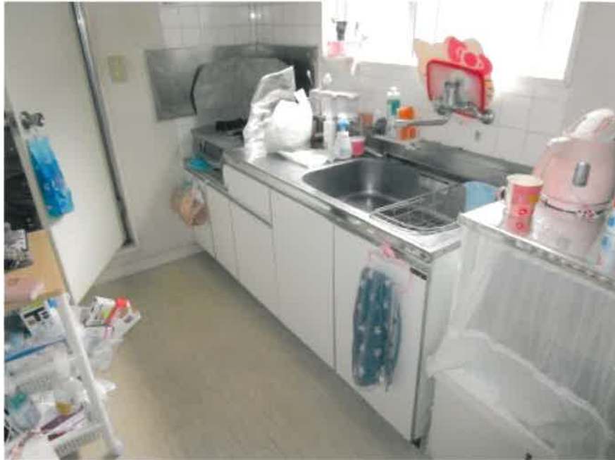
⑨ 建物内の状況 201号室 流し台
