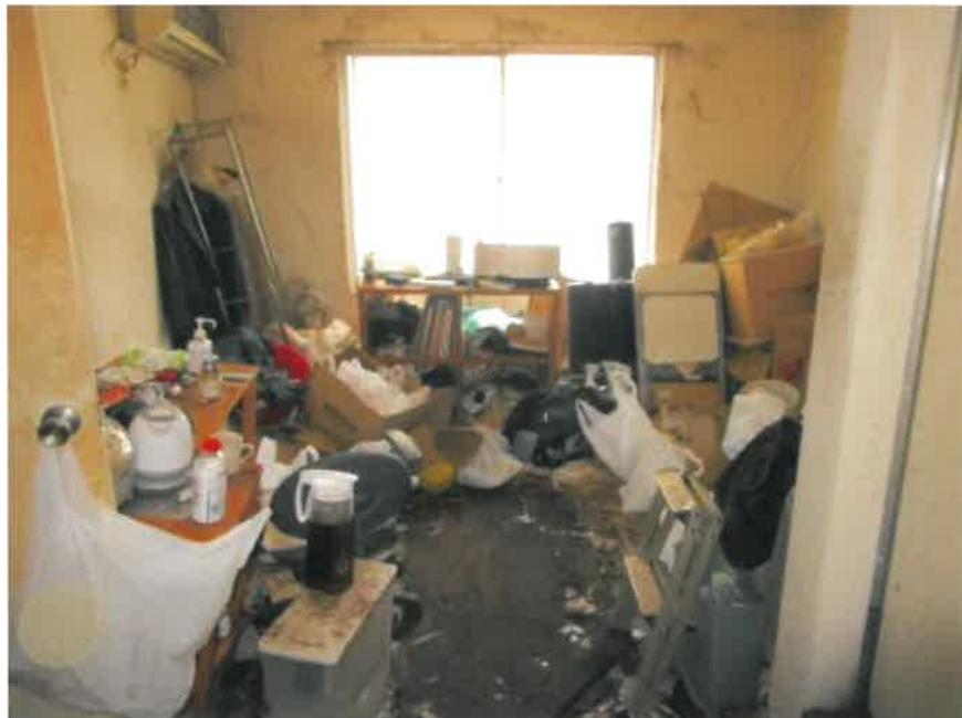
⑮ 建物内の状況 床の損傷が激しい部屋 102号室 LDK
