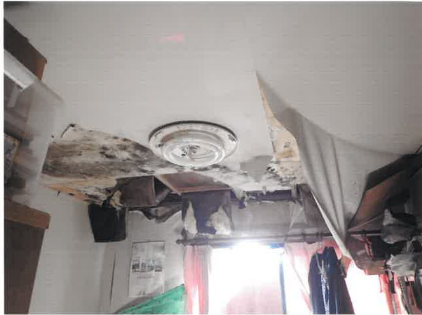
⑦天井損傷の状況
