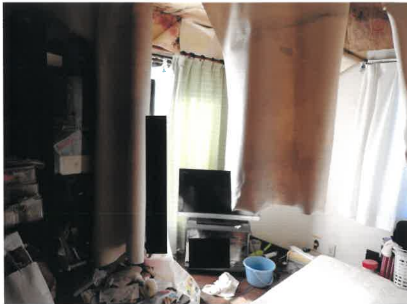
⑧天井の壁紙が剥がれて垂れ下がっている状況
