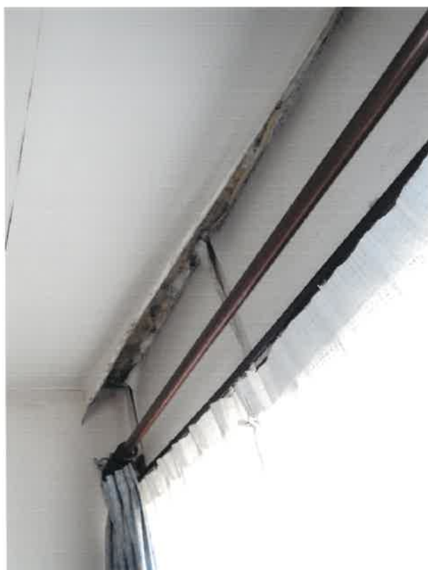
⑩天井の損壊状況
