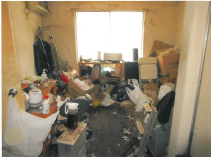
⑳ 建物内の状況 床の損傷が激しい部屋 102号室 LDK
