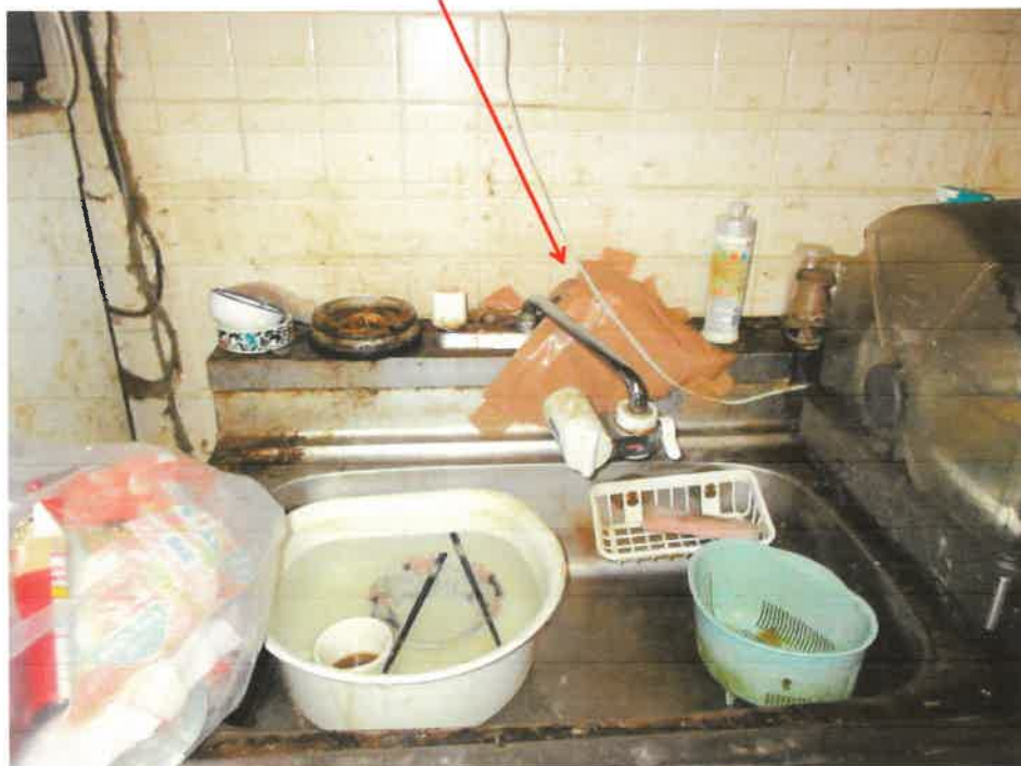
蛇口の損傷状況
