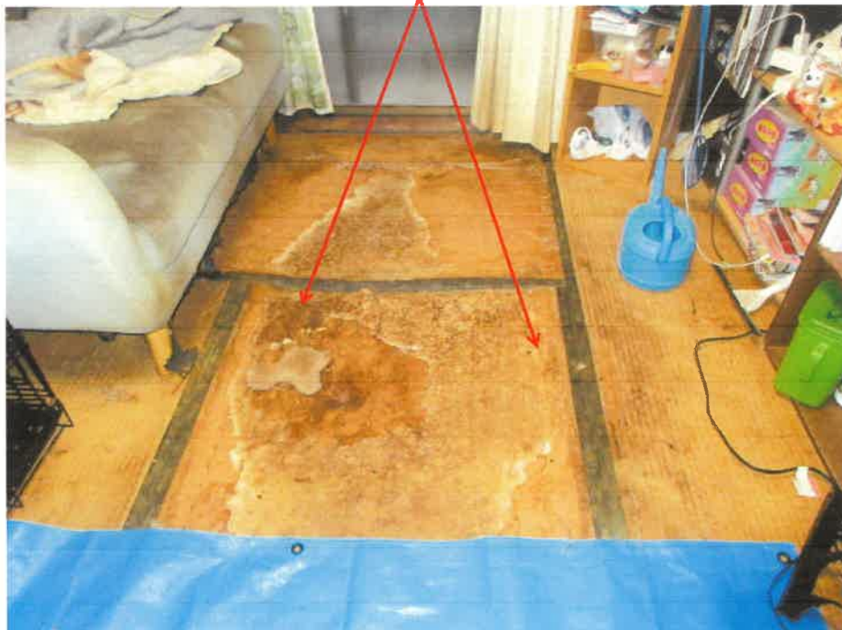
畳の損傷状況
