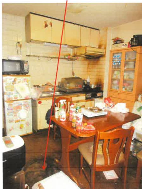
床の損傷状況
