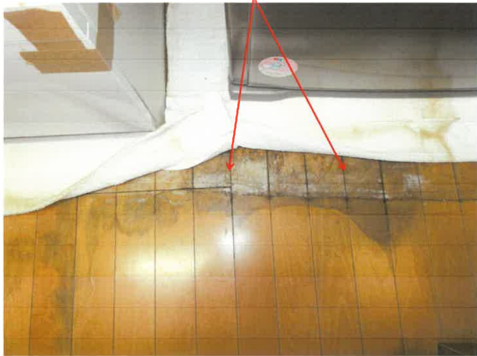
床の損傷状況
