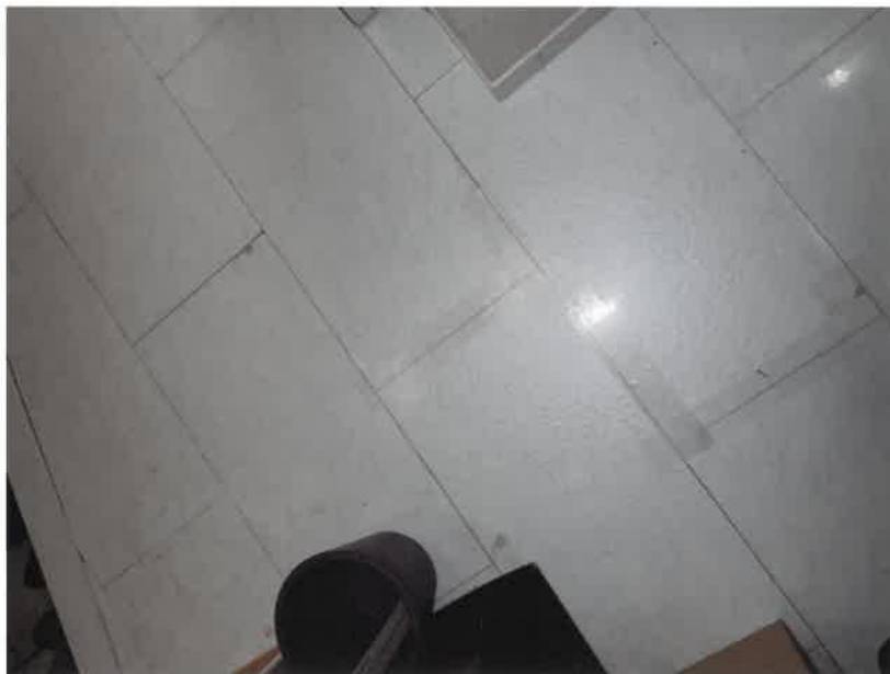
⑦床面がテープで補修されている状況
