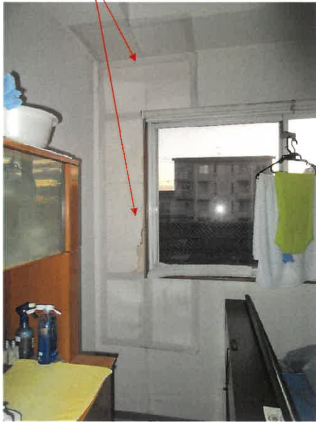
⑦ 雨漏り箇所
