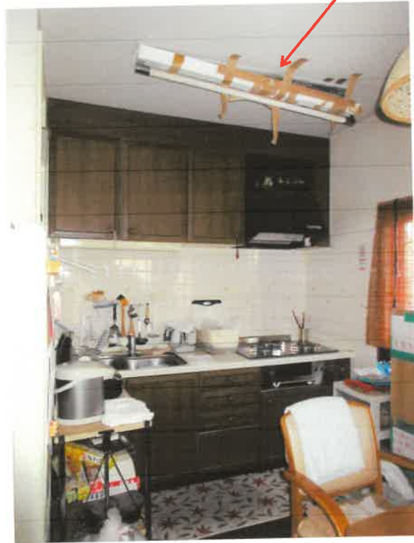
照明器具の損傷状況
