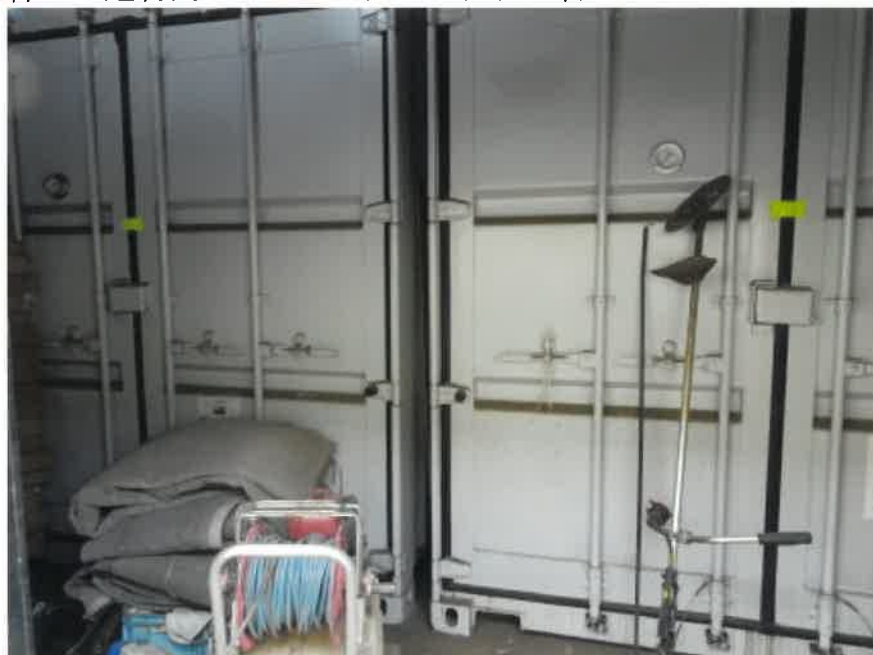
⑥ 物件4の建物内のエージングコンテナ2台
