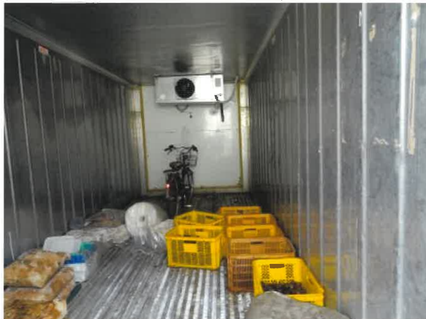
⑦ 物件4の建物内のエージングコンテナ内部
