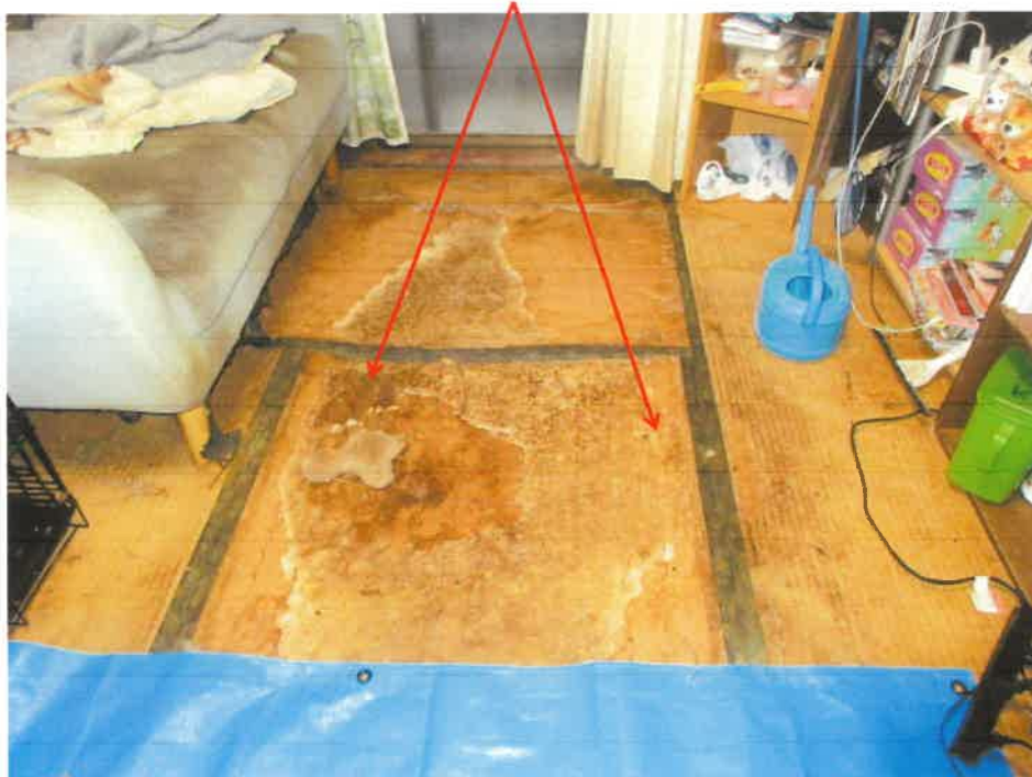
畳の損傷状況
