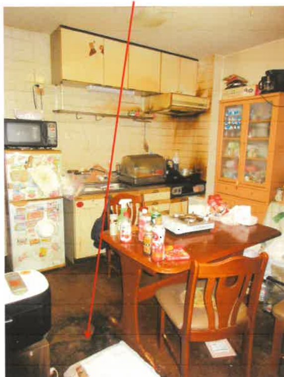
床の損傷状況
