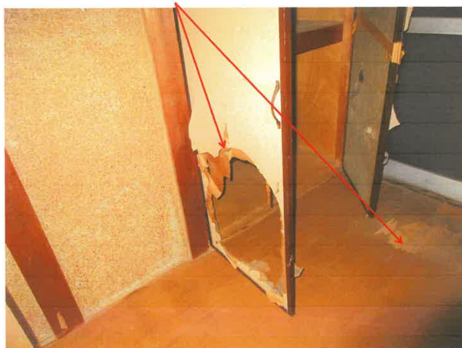
収納及び床の損傷状況
