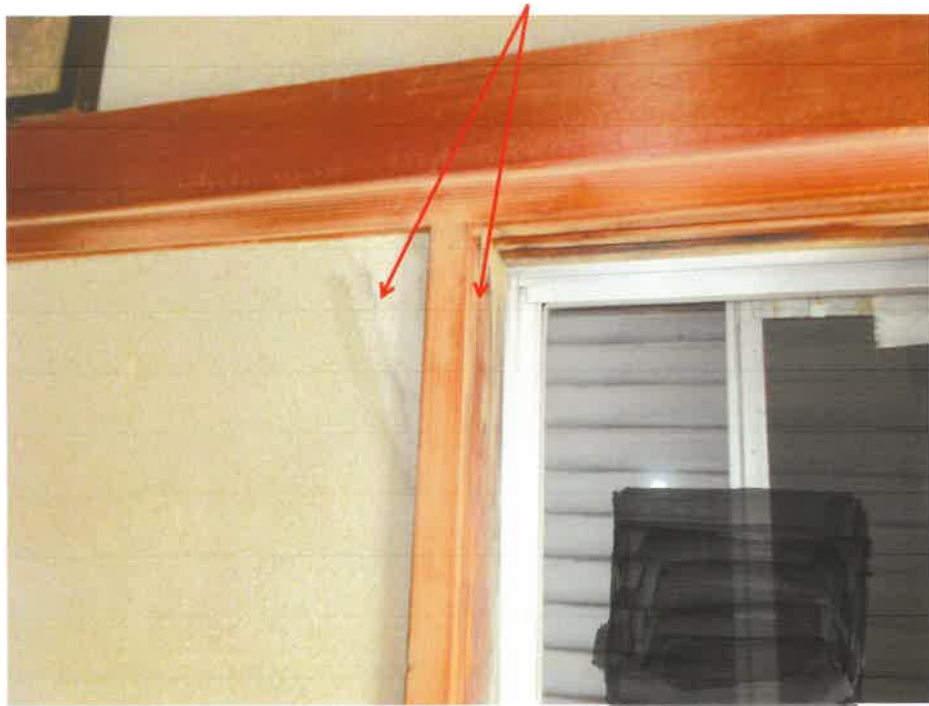
雨漏り跡の状況
