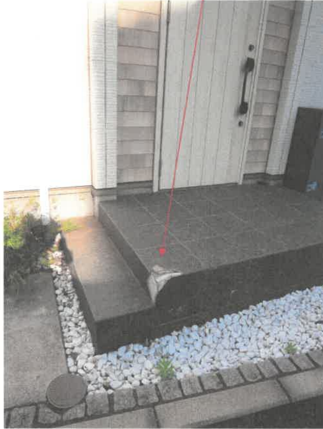
玄関ポーチの破損部分
