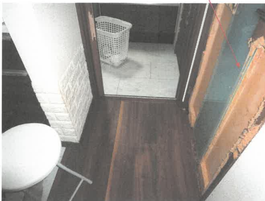
扉の破損状況
