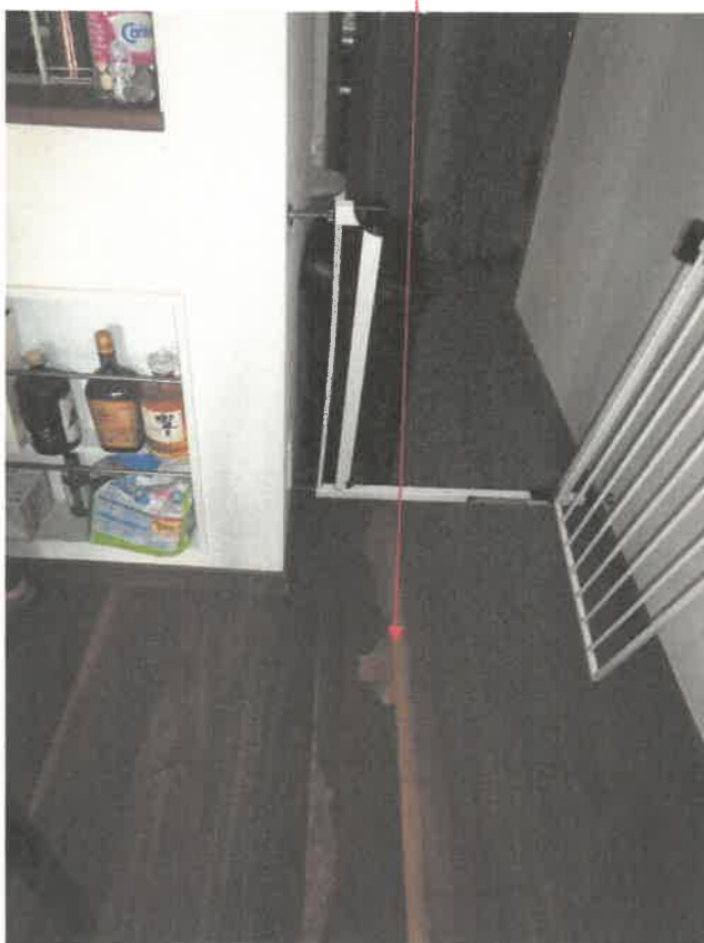
床面の破損状況
