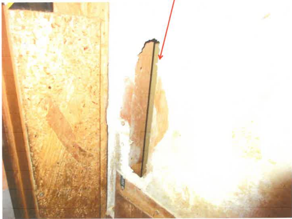
壁面の損傷状況
