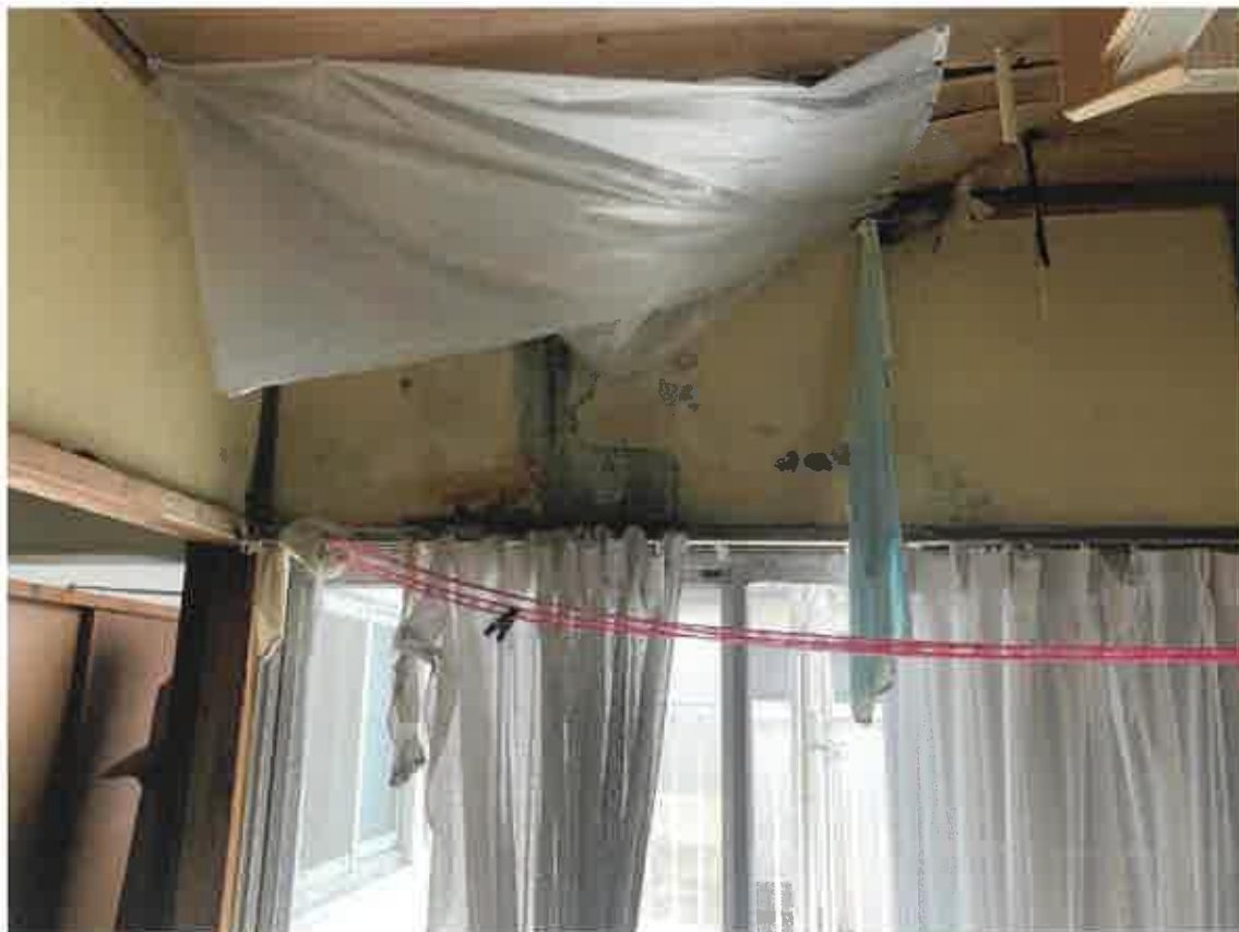
⑨雨漏りの損傷
