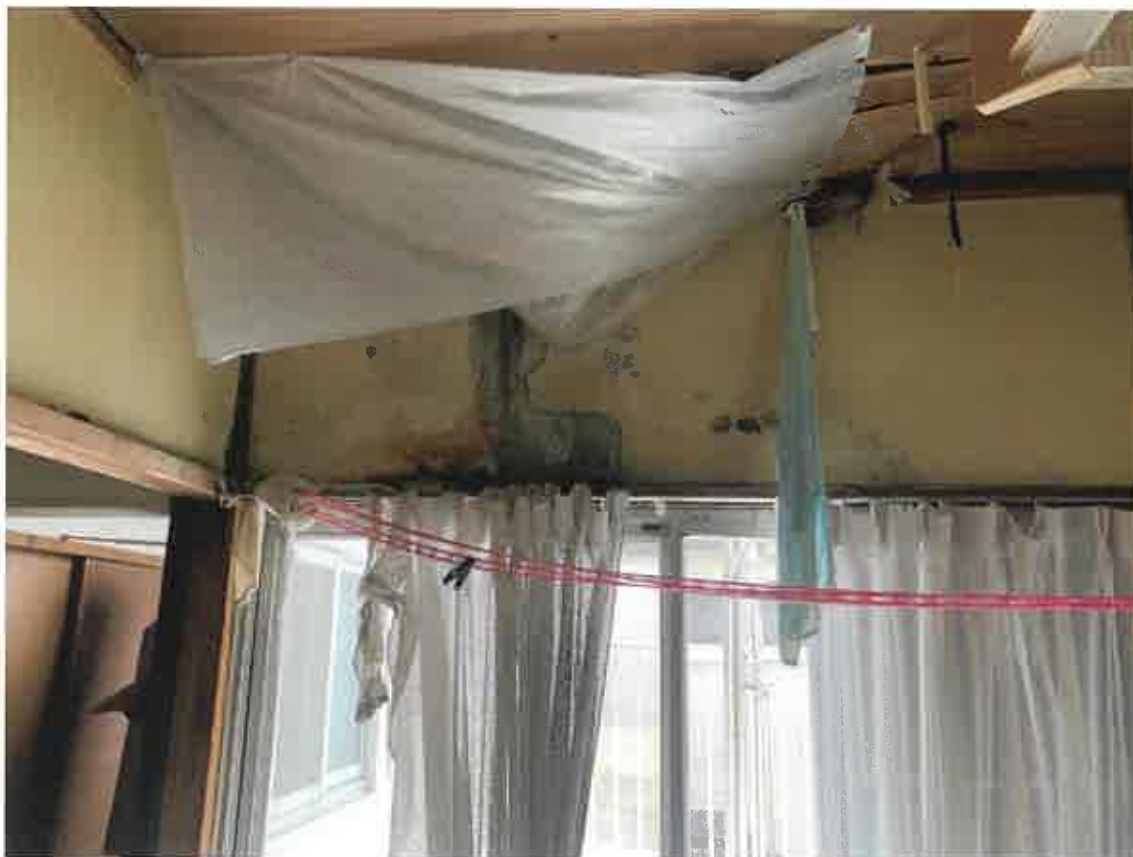
⑨雨漏りの損傷
