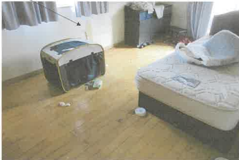
③ 壁紙の損傷
