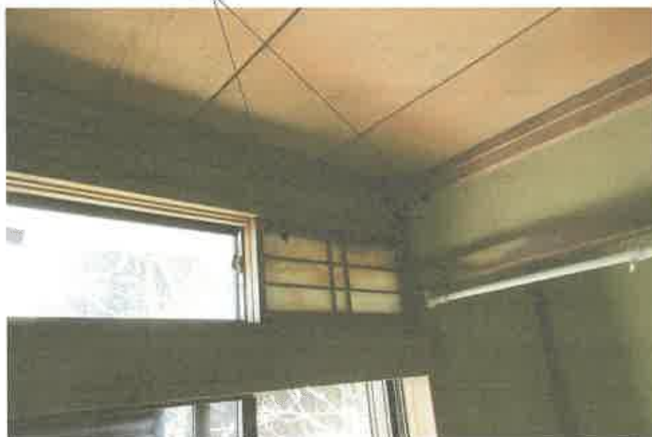
⑧ 雨漏りによると思われる汚損
