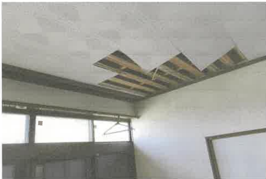
⑦ 天井の破損
