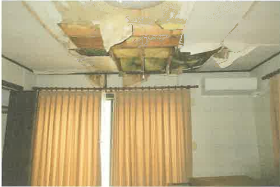
⑤ 雨漏りによると思われる破損
