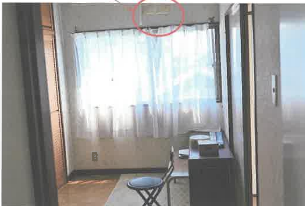
⑦ 壁紙が剥がれている
