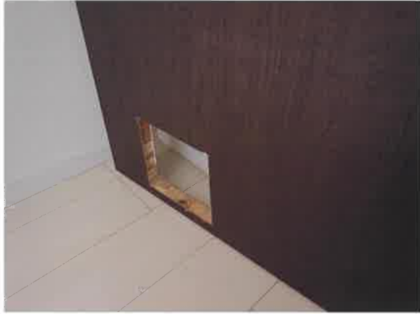
⑦ 2階洗面所出入口ドアの状況
