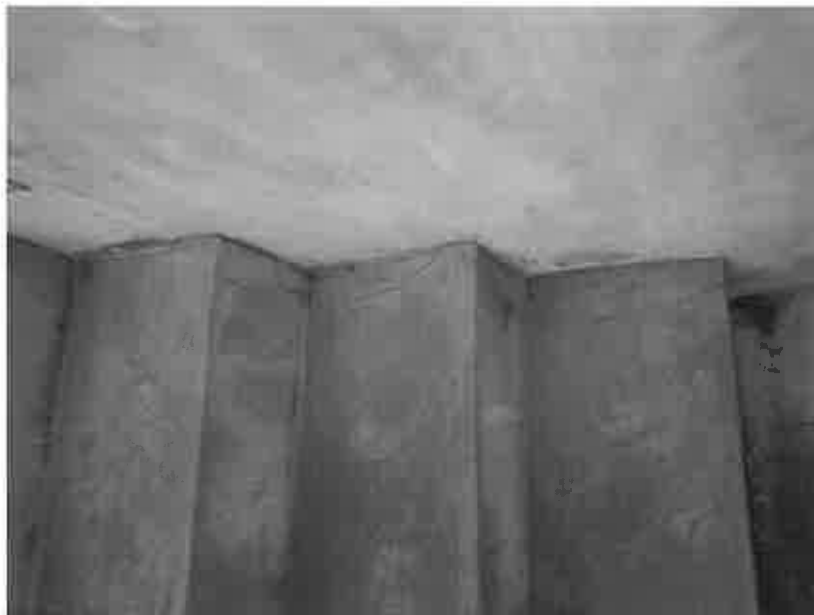
⑦ 玄関に至る階段ひび割れの状況
