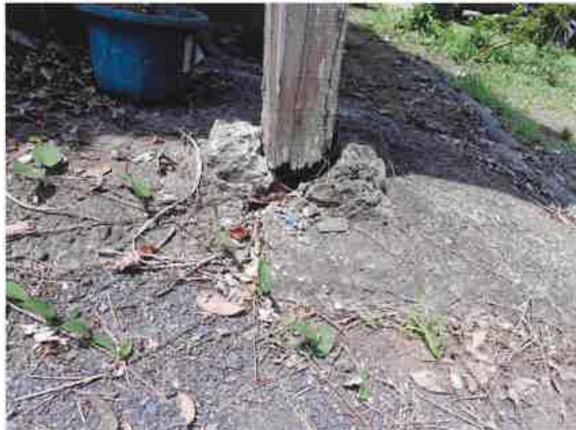
⑧ 前同建物柱の損傷状況
