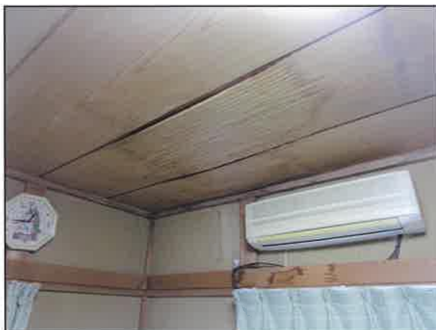
⑥ 建物内の状況—和室:天井の雨漏り跡(1階)
