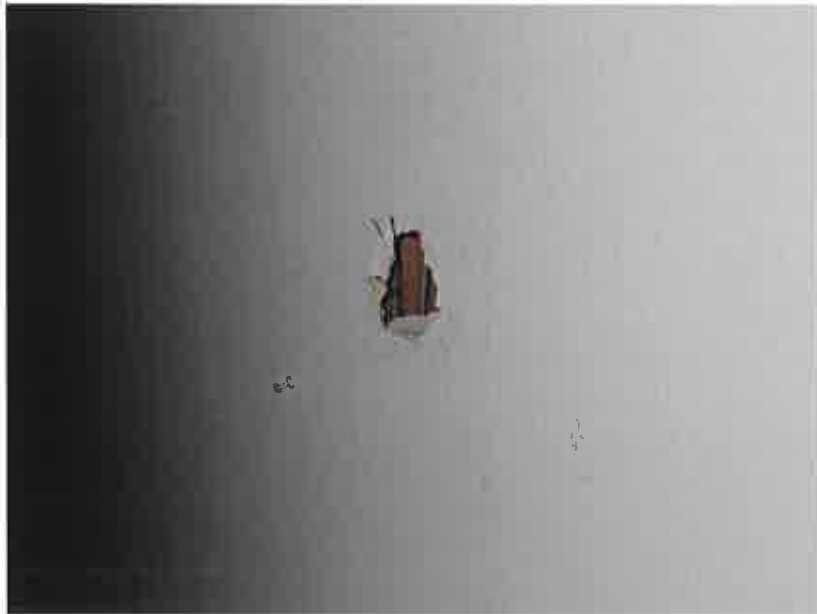
⑧ 壁面損傷の状況
