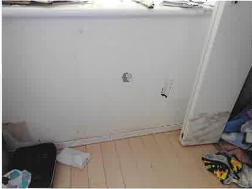
⑦ 壁面損傷の状況
