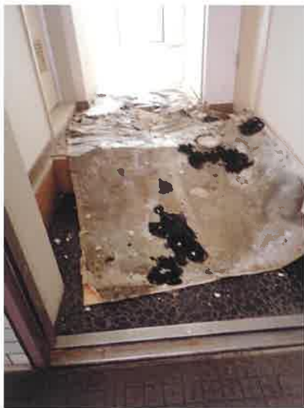
③ 崩落した天井部材の状況
