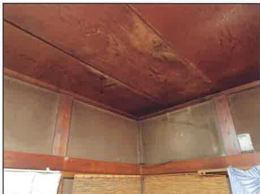
⑥ 建物内の状況－和室2:天井の雨漏り跡(1階)
