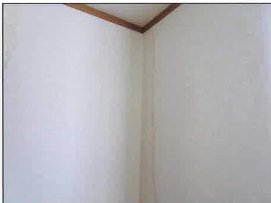
⑧ 建物内の状況－壁面クロスの汚れ(2階)
