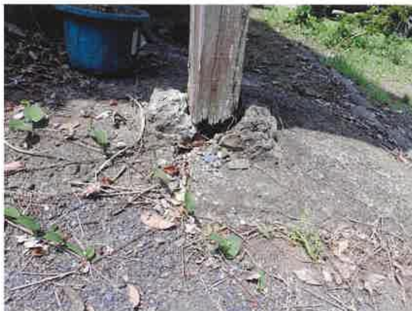
⑧ 前同建物柱の損傷状況
