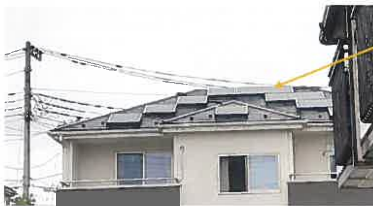
太陽光パネル
