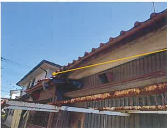
屋根と雨樋の損壊
