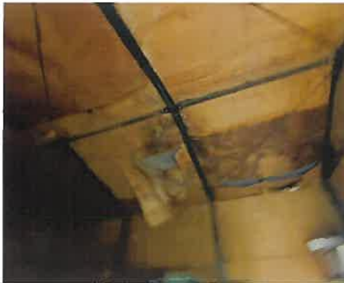
天井板の損壊
