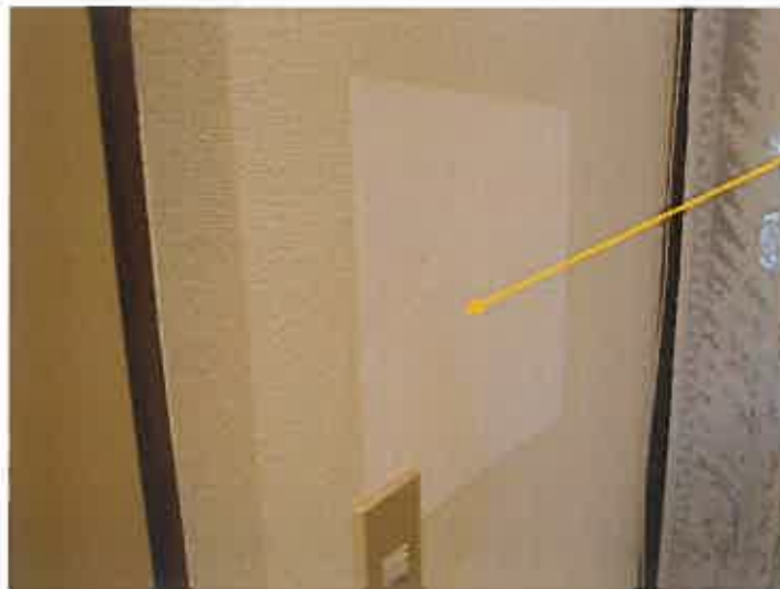
壁クロスの穴の 補修跡
