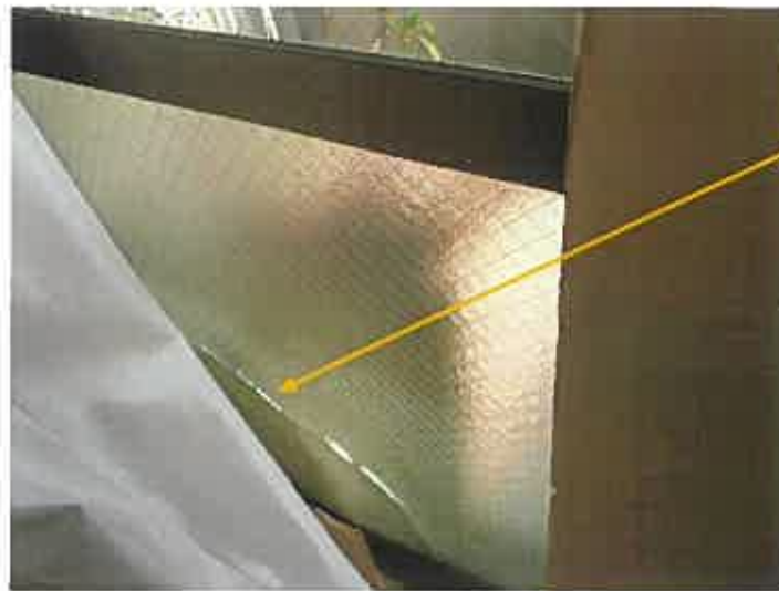
サッシガラスの 破損
