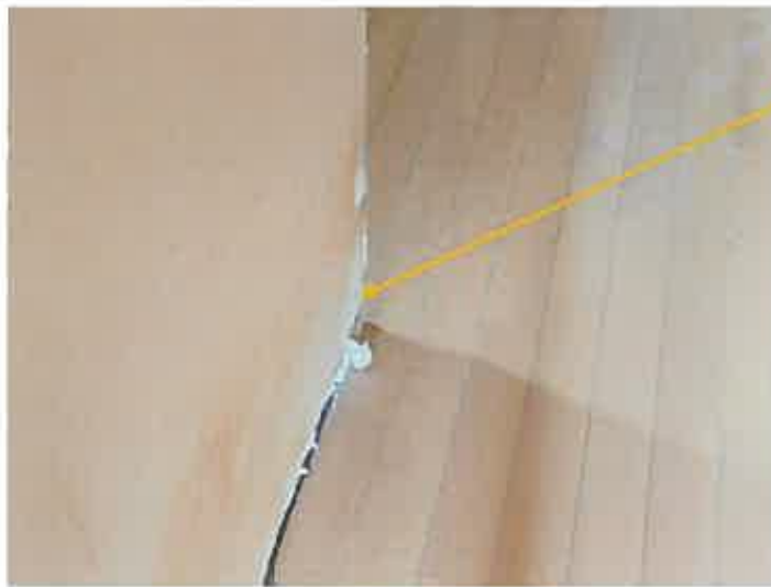
ペットによる 壁クロスの傷み
